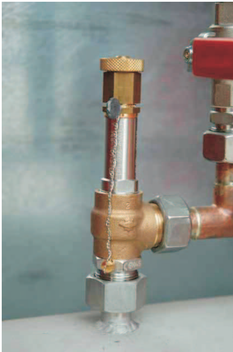
На фото: предохранительный клапан на буферном сосуде.
