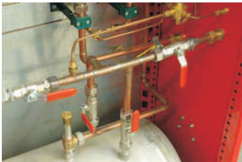
На фото: обвод (байпас) для буферных сосудов, предувочная трубка
